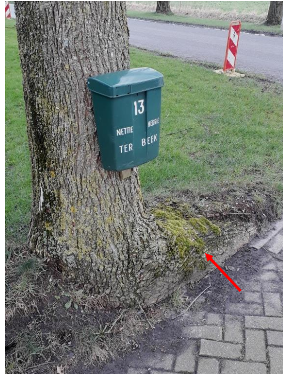
Boom 168678, afwijkende stamvoet met slechts één forse wortelaanzet. De rest van de stam 'verdwijnt' rechtstandig in de grond.
